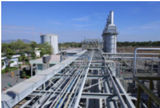
Nhà máy xử lý khí Dinh Cố
